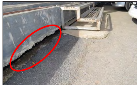
Kompleks Perikanan Kuala Sanglang, Kedah - Mendapan Tanah Bangunan Pejabat Kompleks (23.05.2017)
