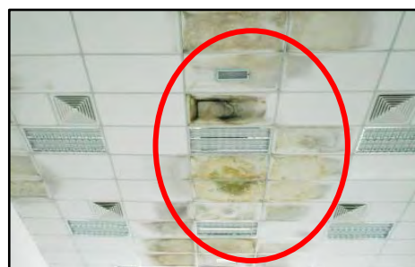
Bangunan Hangar - Terdapat Resapan Air di Permukaan Siling (11.07.2017)
