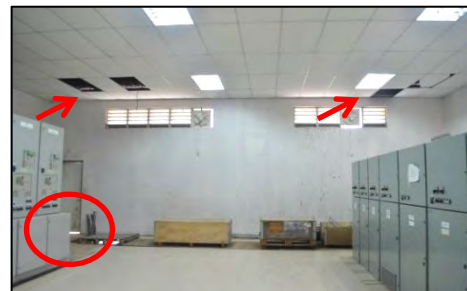
PPU Simpang Bongkol, Pitas - Siling Bangunan PPU Belum Siap Sepenuhnya (15.05.2017)
