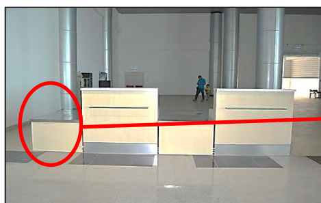
Bangunan Terminal, Jeti Kuah, Langkawi, Kedah - Kelengkapan Luggage Counter JLM Tidak Digunakan (29.03.2017)
