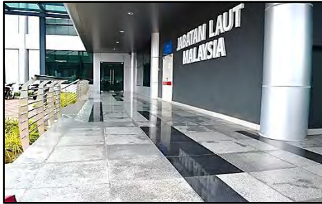
Kawasan Luar Bangunan CIQ, Jeti Kuah, Langkawi, Kedah - Permukaan Lantai Granite yang Mempunyai Kesan Tompokan Resapan Air (29.03.2017)
