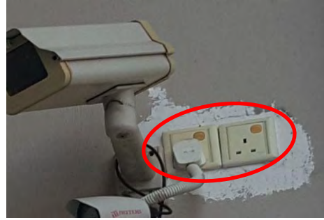
Hangar, Ruang Luar - Punca Kuasa Kamera CCTV Tidak Dilindungi Daripada Kesan Cuaca dan Air (10.07.2017)
