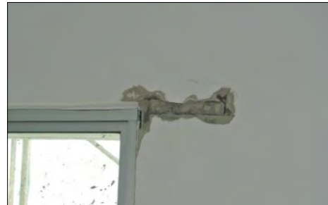
Residensi Hijauan Lumayan - Kerosakan Pada Dinding di Ruang Tamu, Unit Rumah Contoh (09.05.2017)
