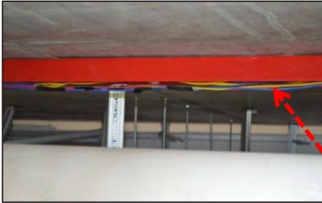
Terminal Skypark Subang Dalam Siling di Concourse (Aras Bawah) - Trunking Dipasang Terus pada Papak Konkrit (10.01.2017)
