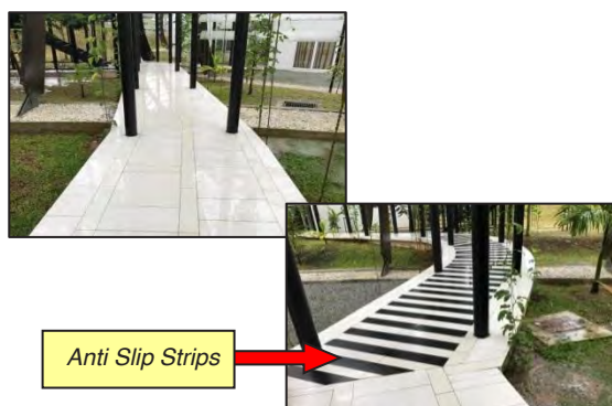
Koridor Aras 1, di Antara Dome 1 dan Dome 2 - Anti Slip Strips Dilekat Atas Lantai yang Licin oleh CFF untuk Mengelakkan Pengguna Tergelincir (20.03.2017)
