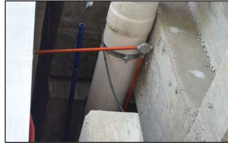
Terminal Skypark Subang Laluan Awam (Aras Bawah) - Kedudukan Rain Water Down Pipe (RWDP) Berada di Atas Konduit Elektrik (10.01.2017)
