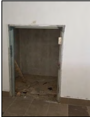
Kompleks Bomba, Aras Bawah - Ketinggian Pintu Bilik Riser Elektrik yang Menempatkan Papan Agihan Berukuran 900 mm (W) X 1500 mm (H) Lebih Kecil Berbanding Ukuran Standard iaitu 900 mm (W) X 2100 mm (H) (11.07.2017)
