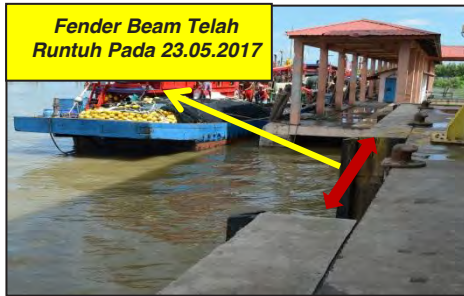
Kompleks Perikanan Kuala Kedah, Kedah - Fender Beam di Jeti Pendaratan Ikan Telah Jatuh ke Dalam Air Pada 23 Mei 2017 Menyebabkan Seorang Nelayan Cedera (24.05.2017)
