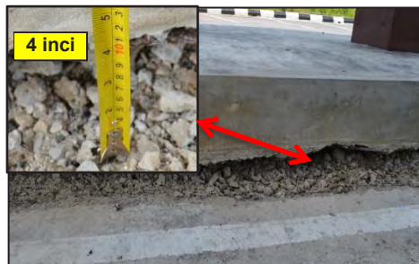
Kompleks Perikanan Beladin, Sarawak - Berlaku Mendapan Tanah di Bangunan Pentadbiran Kompleks (16.05.2017)
