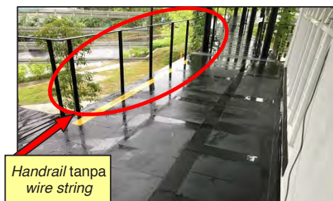
Link Bridge Aras 2, Antara Dome 2 dan Dome 3 - Handrail Tanpa Wire String (Ruang Terbuka) Amat Berbahaya Kepada Pengguna (20.03.2017)
