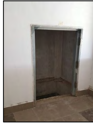
Kompleks Bomba, Aras Atas - Ketinggian Pintu Bilik Riser Elektrik yang Menempatkan Papan Agihan Berukuran 900 mm (W) X 1500 mm (H) Lebih Kecil Berbanding Ukuran Standard iaitu 900 mm (W) X 2100 mm (H) (11.07.2017)
