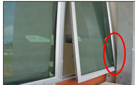
Kompleks Perikanan Beladin, Sarawak - Tingkap di Bangunan Pentadbiran Tidak Boleh Dibuka Dengan Sempurna Disebabkan Terhalang Dengan Paip Lualan Air (16.05.2017)
