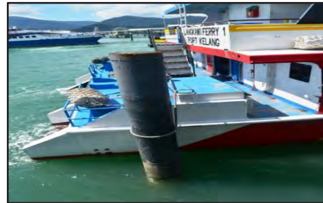
Jeti Kuah, Langkawi, Kedah - Tali Penambat Feri Disangkut Pada Tiang Fender Pile (06.09.2017)
