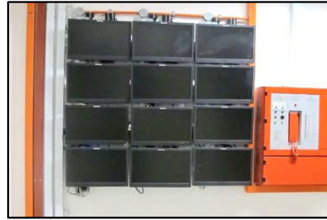
Keseluruhan Blok Bangunan - Monitor Tidak Ditutup Dengan Baik Mengakibatkan Kotor dan Berhabuk (10.07.2017)
