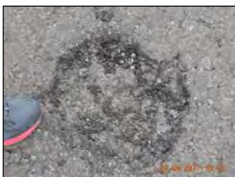
Persimpangan Peringgit - Pothole di Jalan Sedia Ada (27.04.2017)
