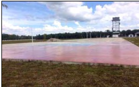
Institut Kemahiran Belia Negara (IKBN), Tanah Merah - Gelanggang Bola Jaring dan Bola Tampar - Kerosakan telah dilaporkan dalam Laporan Kecacatan/Kerosakan No. 1. Pihak kontraktor masih dalam tindakan untuk membaiki kerosakan yang berlaku. Pihak kontraktor telah melantik pihak ketiga iaitu 'specialist' dalam kerja-kerja pembinaan gelanggang untuk membaiki/membuat semula gelanggang tersebut. Status terkini adalah pihak kontraktor sedang menjalankan kerja-kerja 'hacking' bagi kesemua gelanggang yang terlibat. Tarikh jangkaan siap adalah 28.09.2017. (21.08.2017)
