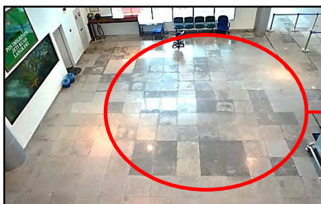
Hadapan Pejabat Imigresen, Bangunan CIQ, Jeti Kuah, Langkawi, Kedah - Permukaan Lantai Granite yang Mempunyai Kesan Tompokan Resapan Air (29.03.2017)
