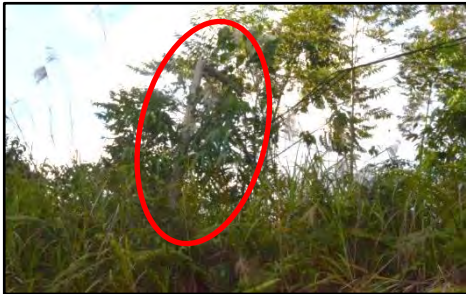
Laluan Ke Kg. Patian Tengah, Tenom - Tiang Elektrik Telah Patah (26.04.2017)
