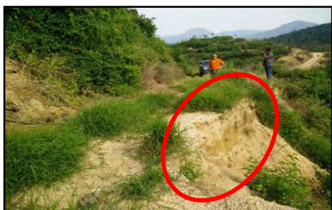
Blok 3, Ladang Sejahtera Ganda - Keadaan Bahu Jalan Cawangan Ladang yang Runtuh dan Tidak Boleh Dilalui Disebabkan Tanah Berbukit Pasir dan Struktur Tanah Lemah (08.02.2017)
