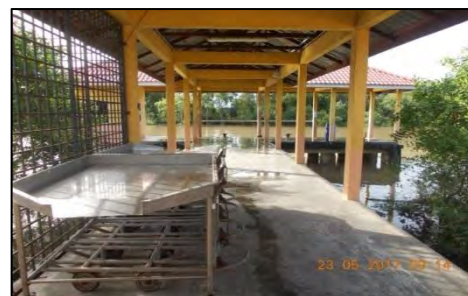
Kompleks Perikanan Kuala Sanglang, Kedah - Jeti Pendaratan Ikan Tidak Digunakan Sepenuhnya (23.05.2017)
