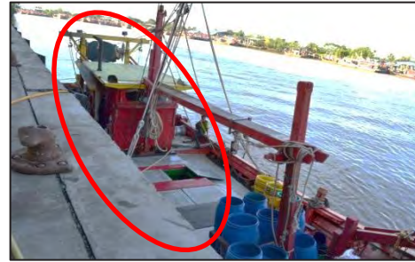
Kompleks Perikanan Kuala Kedah, Kedah - Kedudukan Aras Jeti yang Tinggi Menyebabkan Tekanan Daripada Bot Lebih Tertumpu di Bahagian Bawah Fender Beam (24.05.2017)
