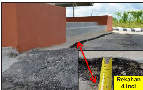
Kompleks Perikanan Beladin, Sarawak - Berlaku Rekahan di Bangunan Pentadbiran Kompleks Dengan Jarak 4 Inci (16.05.2017)
