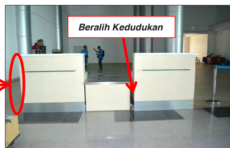
Bangunan Terminal, Jeti Kuah, Langkawi, Kedah - Kelengkapan Luggage Counter JLM Masih Tidak Digunakan dan Kedudukan Telah Berubah (06.09.2017)
