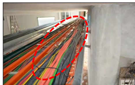
Terminal Skypark Subang Dalam Siling di Concourse (Aras Bawah) - Pemasangan Kabel di Cable Tray Melebihi Had Faktor Ruangan (Space Factor). (10.01.2017)
