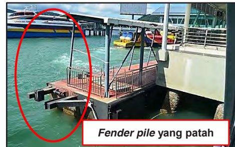
Labuhan 7, Jeti Kuah, Langkawi, Kedah - Fender Pile yang Telah Patah (06.09.2017)
