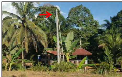
PP Kg. Namukon, Tongod - Penyambungan Talian Elektrik Belum Siap (18.05.2017)
