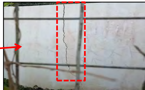
Kg. Patian, Ahuron, Tenom - Binaan Konkrit Pada Bangunan Pencawang Elektrik Retak (26.04.2017)
