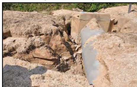
Blok 4, Ladang Sejahtera Ganda - Culvert Yang Dipasang di Jalan Utama Ladang Rosak dan Tidak Berfungsi Kerana Hakisan (08.02.2017)
