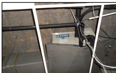
Bangunan Sekolah Sistem - Kesan Karat Pada Fan Coil Unit (11.07.2017)
