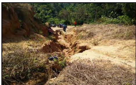
Blok 4, Ladang Sejahtera Ganda - Keadaan Jalan Cawangan Ladang yang Rosak Teruk dan Tidak Boleh di Lalui Kerana Hakisan (08.02.2017)
