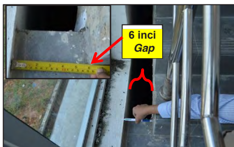
Kompleks Perikanan Beladin, Sarawak - Terdapat Jurang (Gap) 6 Inchi di Antara Dinding dan Tangga ke Tingkat 2 Bangunan Pentadbiran (16.05.2017)
