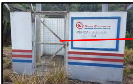
Kg. Katubu, Tenom - Pencawang Elektrik Kg. Katubu (26.04.2017)
