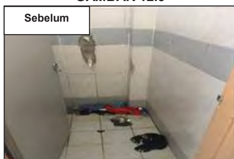
RKK Kota Kinabalu, Sabah - Kebersihan Tandas Asrama Kanak-Kanak Lelaki Tidak Memuaskan (18.10.2016)
