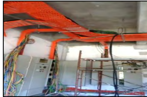
Sekolah Sistem - Pendawaian Elektrik yang Tidak Sempurna dan Tidak Selamat (10.07.2017)
