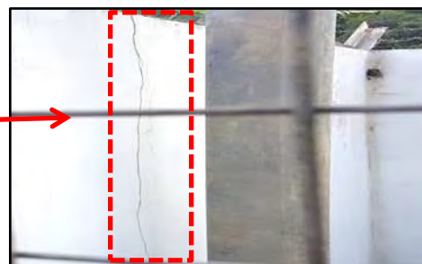
Kg. Katubu, Tenom - Binaan Konkrit Pada Bangunan Pencawang Elektrik Retak (26.04.2017)
