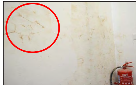
Kompleks Perikanan Beladin, Sarawak - Resapan Air di Dinding Bangunan Pentadbiran (16.05.2017)
