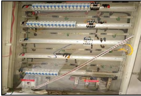
Keseluruhan Blok Bangunan - Pintu Distribution Board (DB) Tidak Ditutup Boleh Mengakibatkan Komponen Hilang Atau Kabel Dipotong (10.07.2017)
