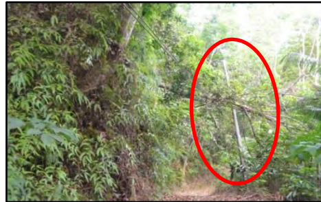
Laluan Ke Kg. Gumuron, Tuaran - Tiang Elektrik Condong (08.05.2017)
